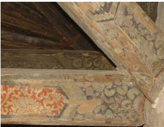
A.5 地仗脱落
